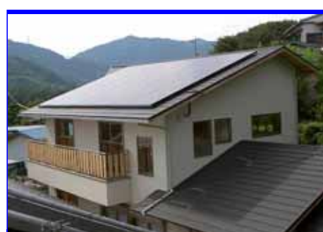
静岡市清水区立花 M 発電所 5.60 kW
