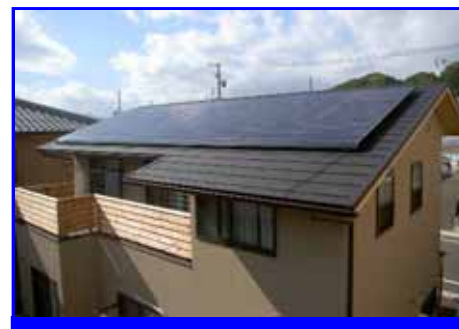
静岡市駿河区大谷 H 発電所 3.84 kW
