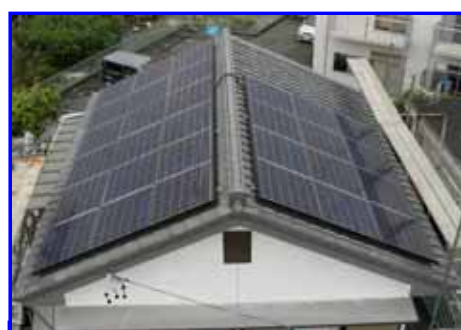
焼津市小土 T 発電所 4.80 kW
