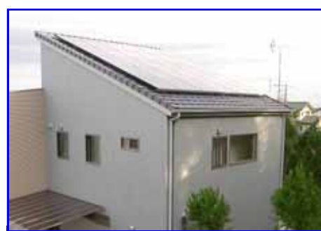
浜松市浜北区平口 N 発電所 4.59 kW
