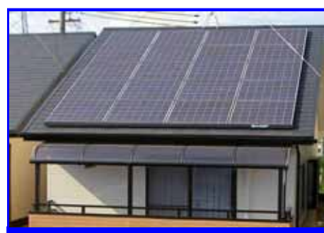
静岡市清水区大坪 K 発電所 3.20 kW
