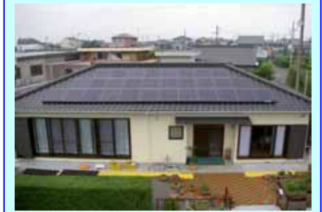
牧之原市新庄 S発電所 4.89 kW
