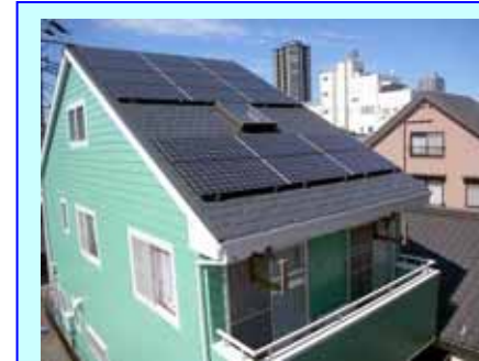
静岡市駿河区 M 発電所 3.87 kW
