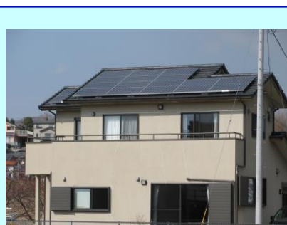
伊東市 I 発電所 4.09kW
