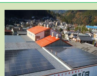
川根本町 (産業用) M 発電所 33.23kW
