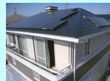
掛川市 S 発電所 4.48kW
