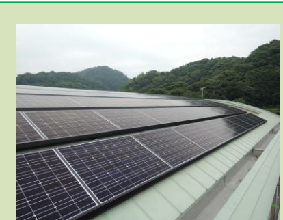
焼津市（産業用） S 発電所 29.0kW
