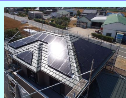
浜松市中区 T 発電所 3.21kW
