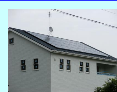
御殿場市 O 発電所 5.46kW
