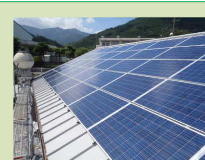
川根本町（産業用） O 発電所 16.57kW
