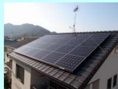
静岡市葵区 H 発電所 4.75kW
