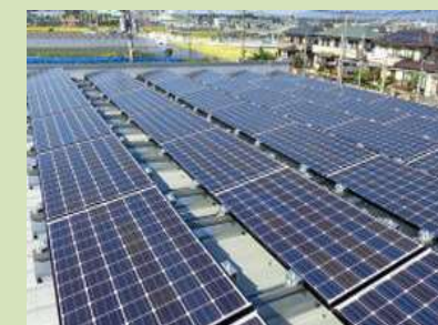
駿東郡清水町 (産業用) M 発電所 10.24kW
