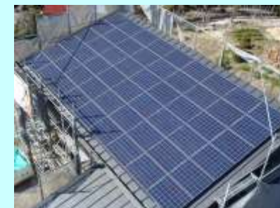
袋井市 M 発電所 10.58kW
