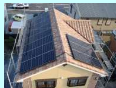
焼津市 Y発電所 6.69kW
